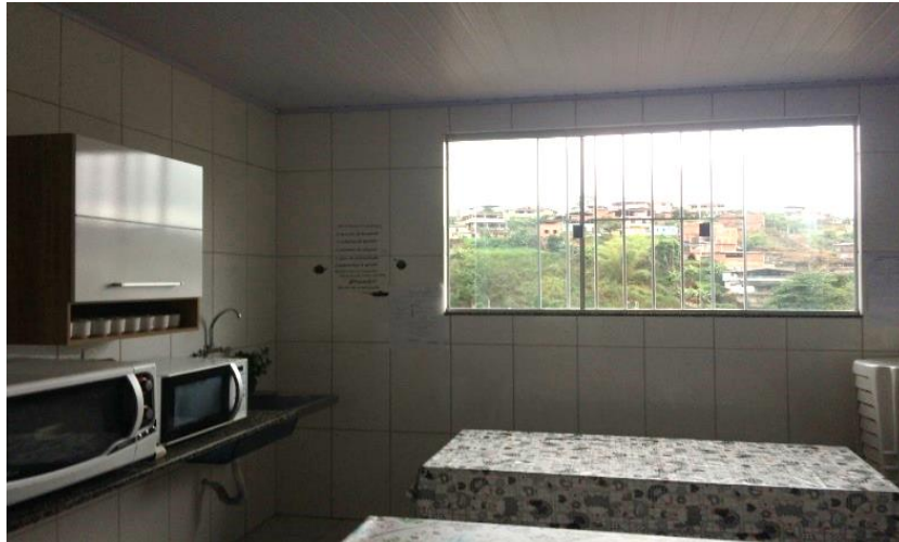
Figura 6 – Iluminação da cozinha Figure 6 – Kitchen lighting
