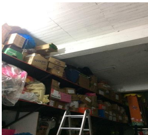
Figura 12 – Caixas interferindo na iluminação do almoxarifado da escola
