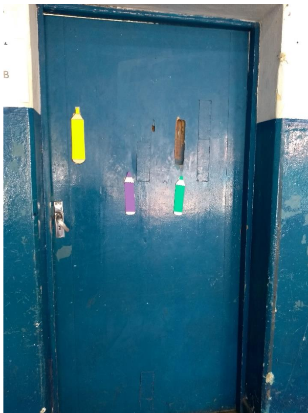
Figura 3 - Deterioração da porta (Fonte: Própria do autor)
