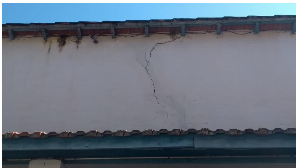
Figura 2 - Trinca por sobrecarga (Fonte: Própria do autor)
