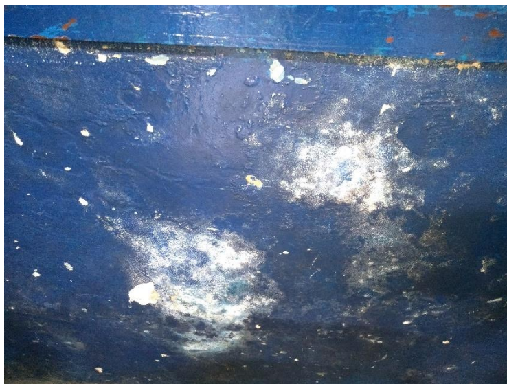
Figura 4 - Manchas de bolor (Fonte: Própria do autor)
